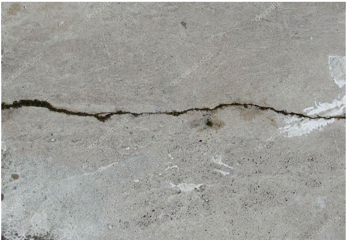
Мал. 1. Типова тріщина в асфальтобетонному покритті
